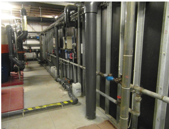
Figure A. 3.3 : Grivegnée : Nouveaux bacs tampon
