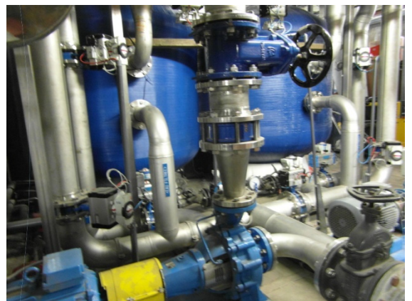
Figure A. 4.6 : Herve : Nouvelles tuyauteries en inox
