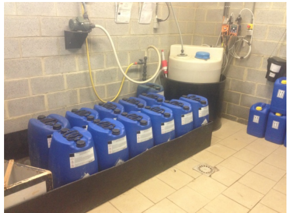
Figure A. 9.4 : Waterloo : Stockage produits chimiques
