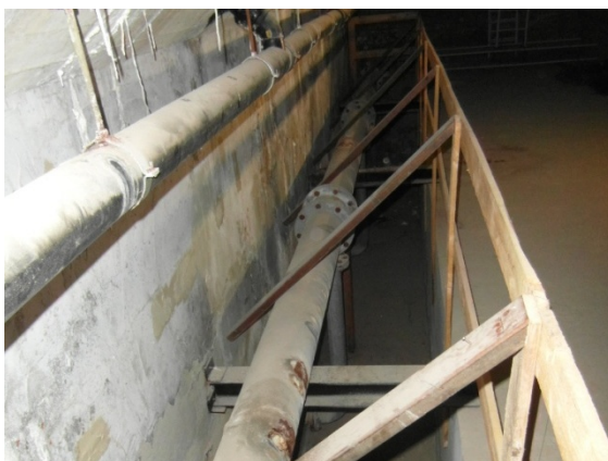
Figure A. 4.5 : Herve : Anciennes tuyauteries corrodées
