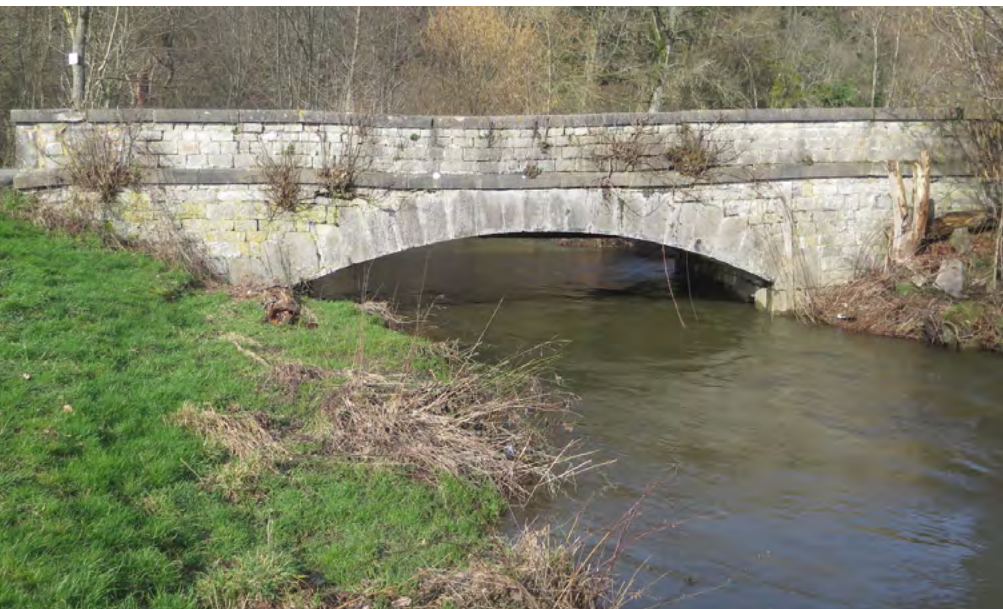
Pont voûte menacant de s'effondrer à Beauraing.
