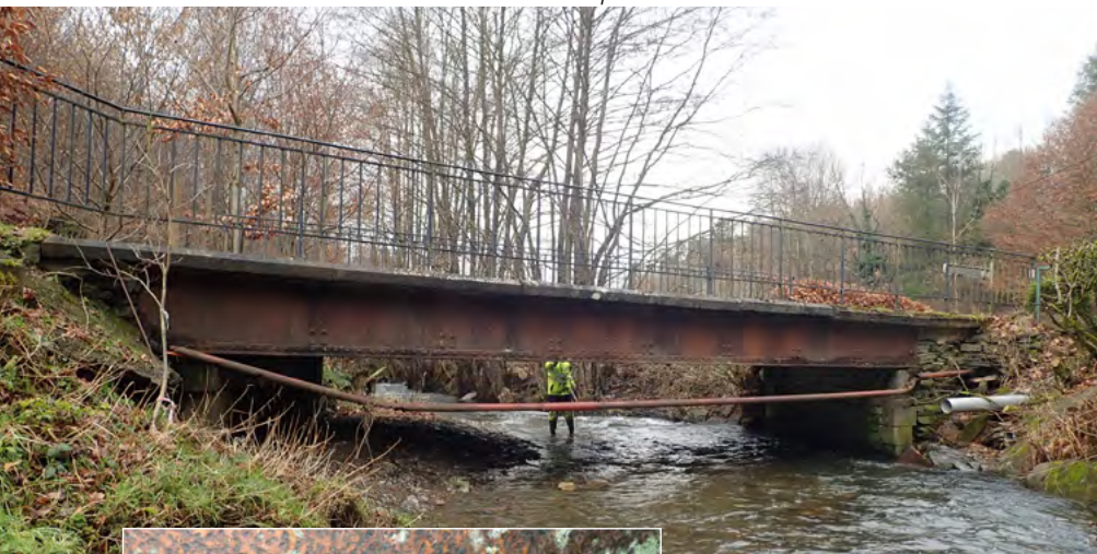
Pont métallique en mauvais état à La Roche-en-Ardenne.
