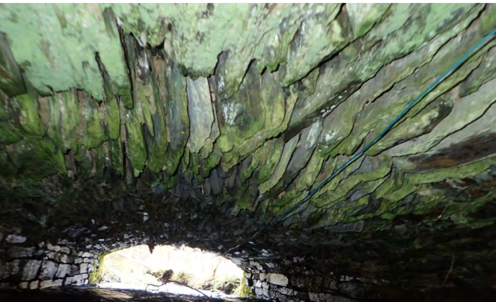
Pont route du fond à la Ferme du Wez à La Roche-en-Ardenne.
