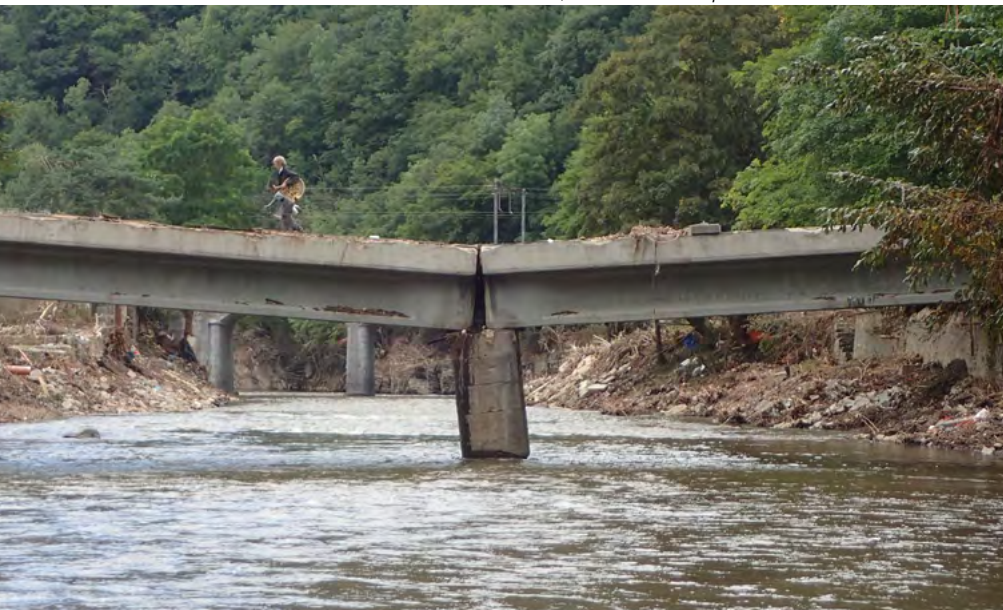
Pont de la Fenderie à Trooz, hors service après les inondations de 2021.
