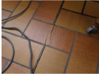
Dégradations du carrelage chez un riverain.
