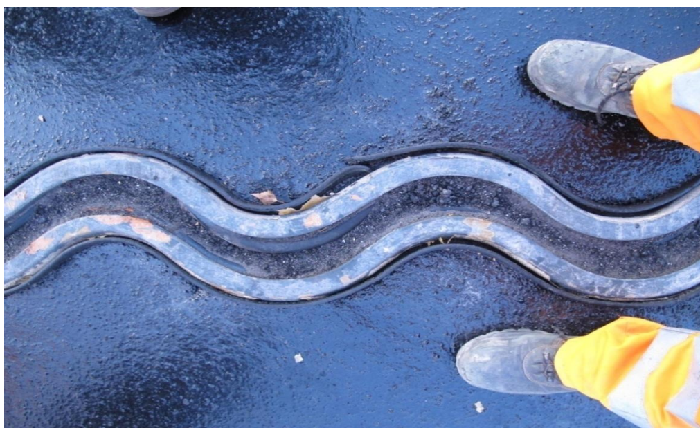
Joint de dilatation sinusoïdal pour en réduire le bruit lors du passage des véhicules
