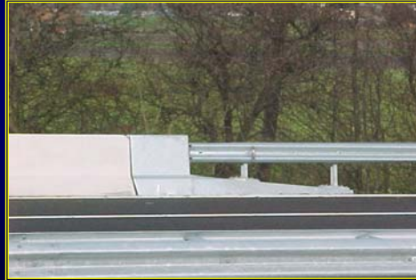
"Dispositifs de retenue routiers"
