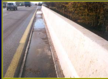
"Dispositifs de retenue routiers"
