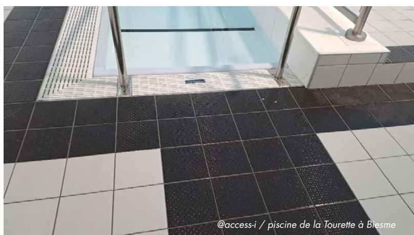
✓ Carrelages déstructurés depuis la sortie du pédiluve vers les bassins
